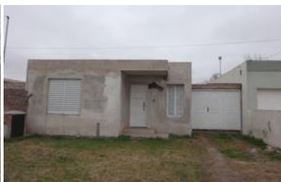
Marcas de inundación en casa, Barrio Belgrano I
